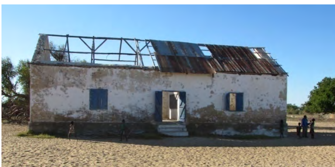
État d'une école avant réhabilitation
